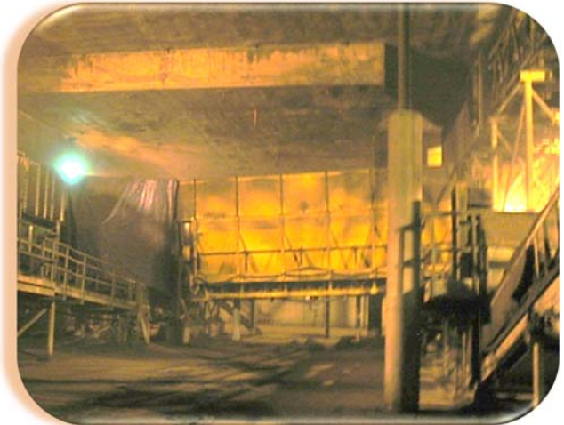
Trommel Screens Dust Collection
