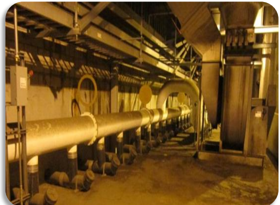
Process Fan Corridor
