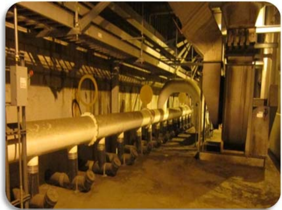
Process Fan Corridor
