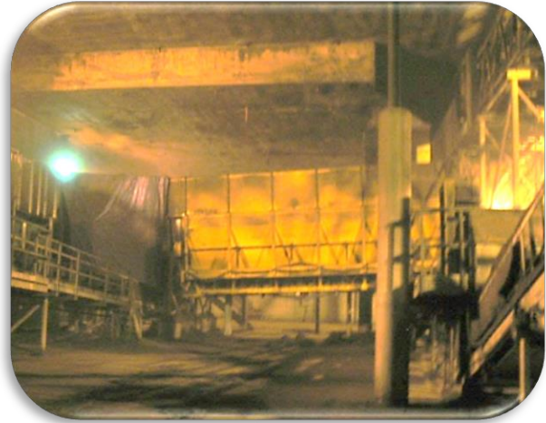
Trommel Screens Dust Collection
