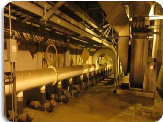
Process Fan Corridor
